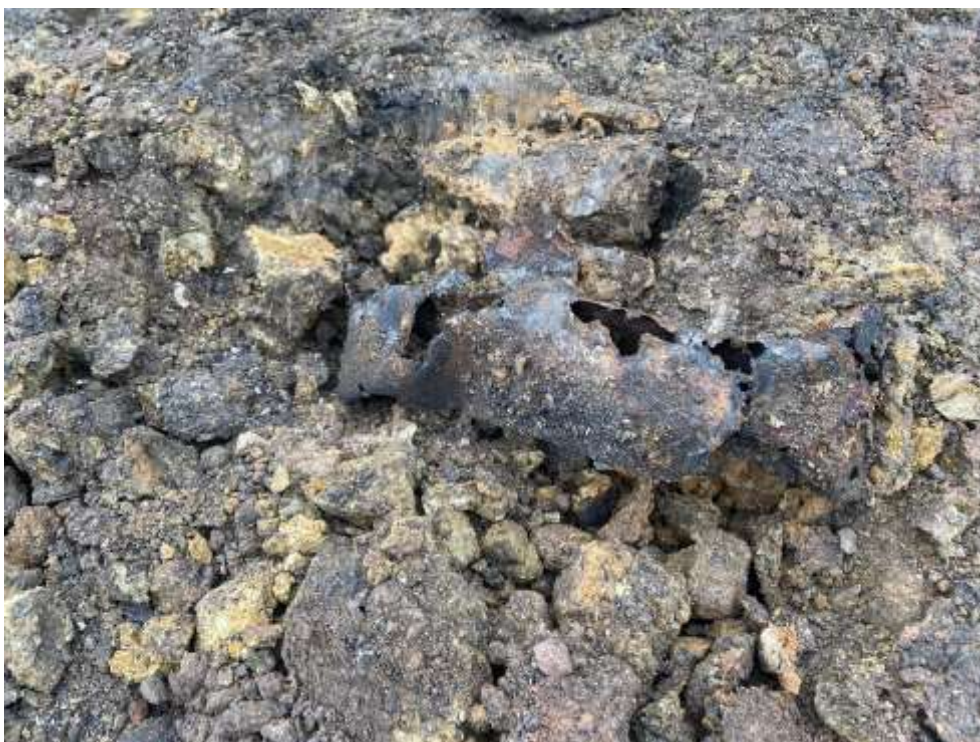
Obr.18 Rozpadající se silně zkorodovaný plech
